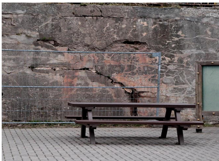
Foto: Schulhof und Schulhofmauer brauchen dringend eine Runderneuerung, an der Stadt und Förderverein gemeinsam arbeiten
